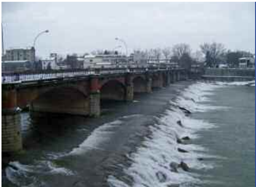
Il ponte della Cittadella recentemente abbattuto
